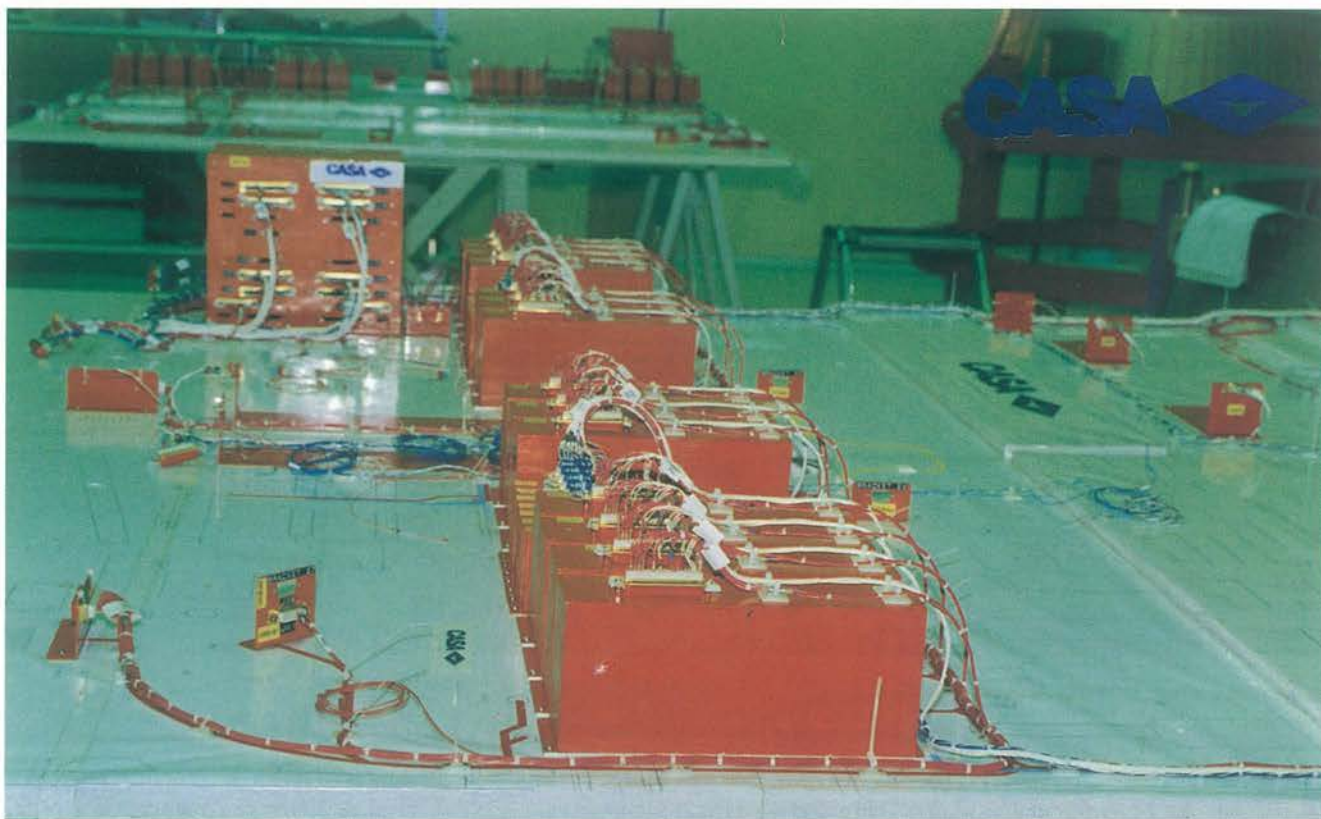
Vista parcial del cableado de un satélite montado en su útil de fabricación tridimensional.
