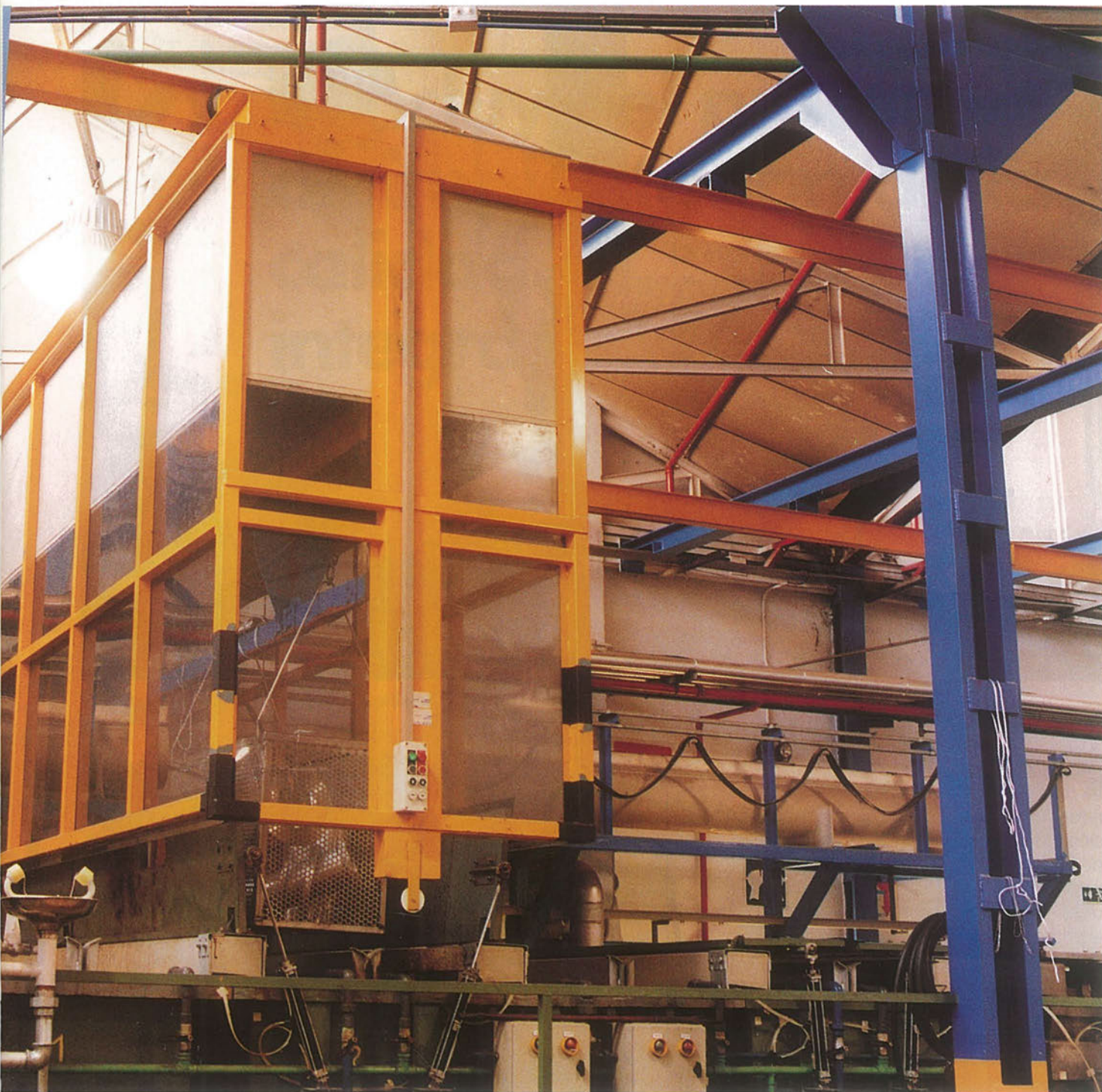
Captación de vapores en instalación de Baños.
