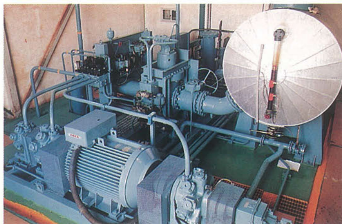
Grupo hidráulico de la prensa Asea (Chapistería integrada).
