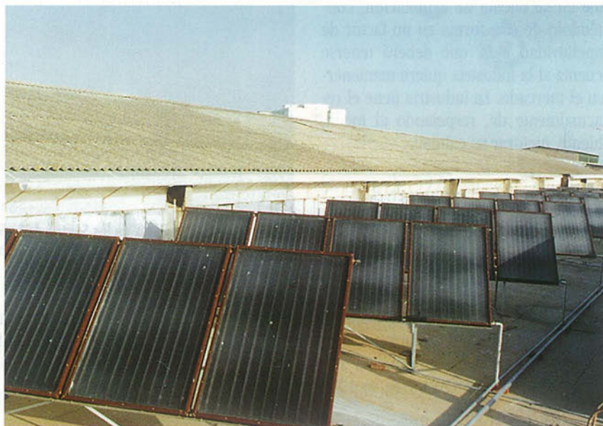
▲ Paneles solares instalados en la Factoría de Cádiz.
