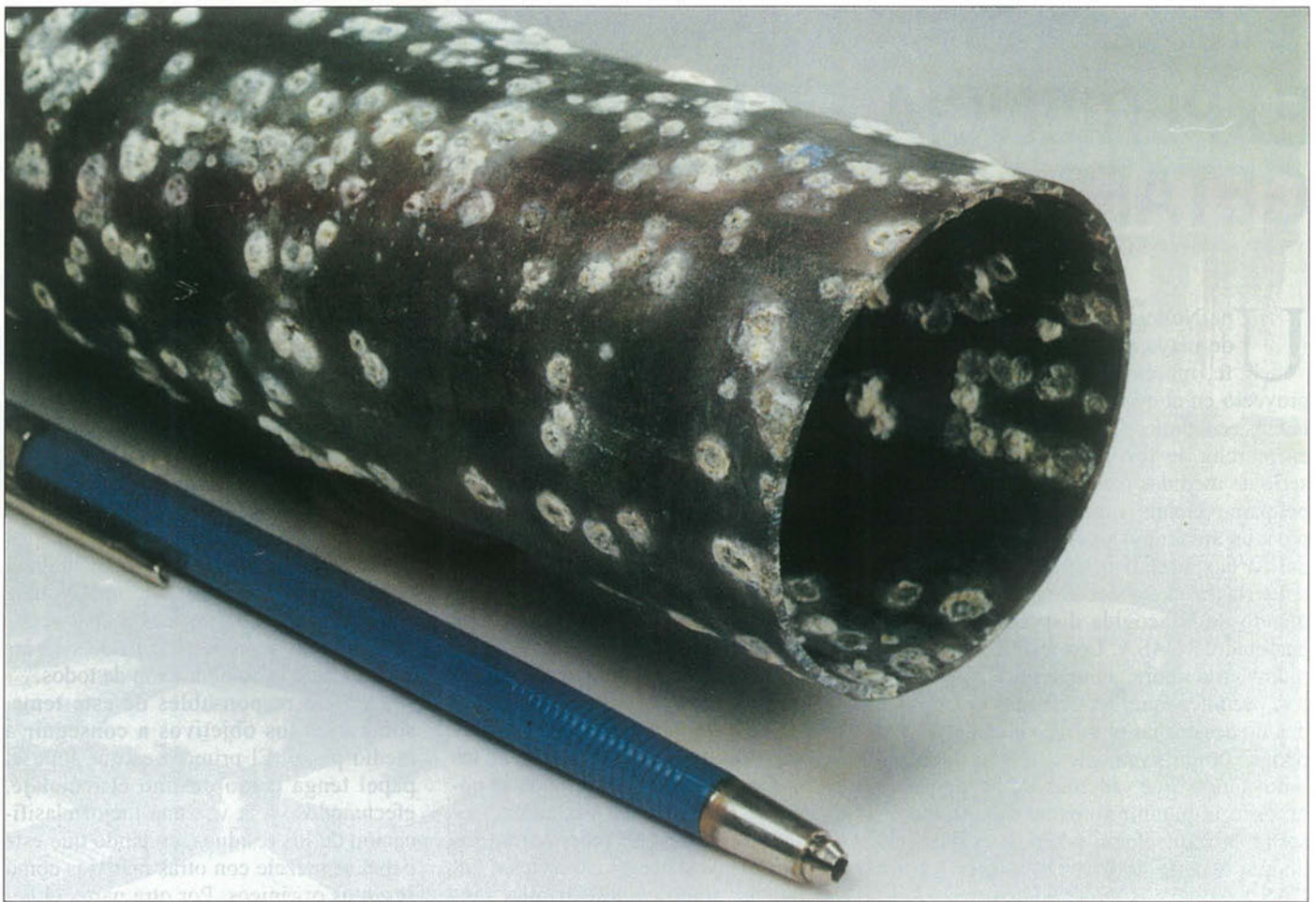
Efectos de la corrosión.
