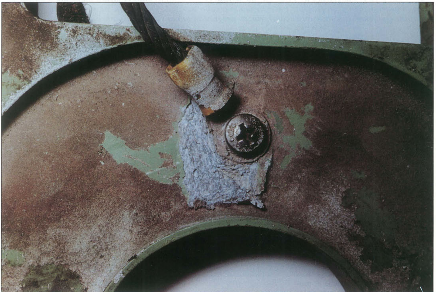
Efectos de la corrosión.
