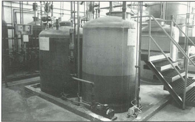
Planta depuradora de la cadena de baños.
