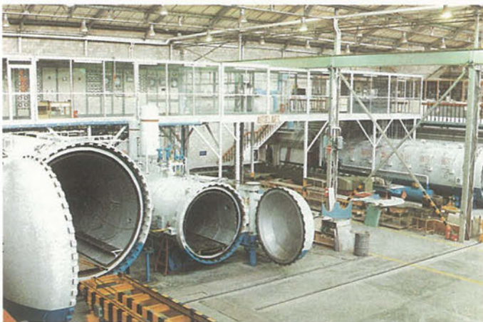
Autoclaves en nave de Composites.
