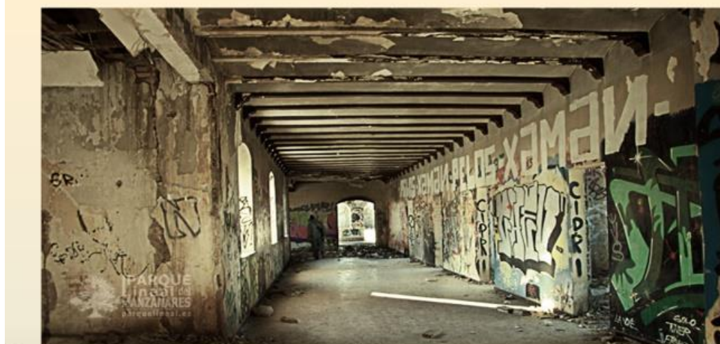
Distribuidor principal. De aquí parte, claramente delimitado, entre otras salas religiosas, el refectorio. El famoso lema ora et labora cobra en esta finca su máxima expresión. Según el Catastro de Ensenada era relevante su producción de vino, de la que se conservan muchas instalaciones. La Aldehuela aparece en las Relaciones del Cardenal Lorenzana (S XVIII) como centro productor. Los monjes trapenses continuarían con dichos trabajos en el campo.
