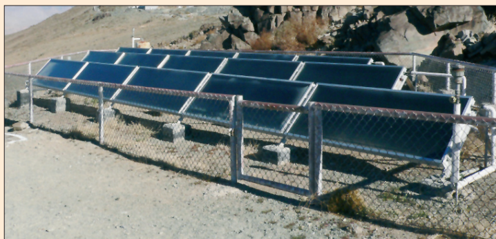
Paneles de energía solar.
