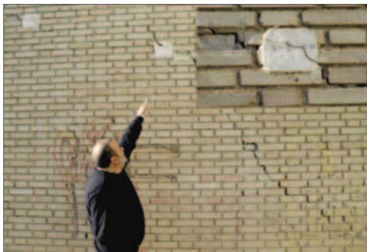
El director del Ortiz Echagüe señala una grieta del edificio.
