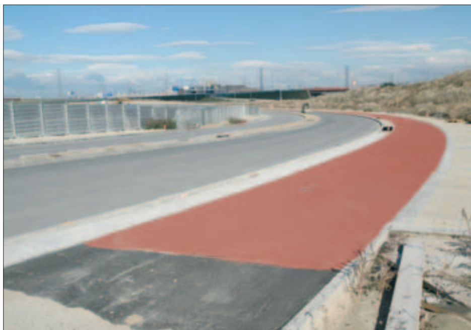
La ejecución de hormigones en el carril bici alcanza el 90% del total.
