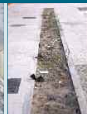
Mediana del aparcamiento de la avenida de Aragón sin plantas por obras pero con suciedad. / F. Herrón
