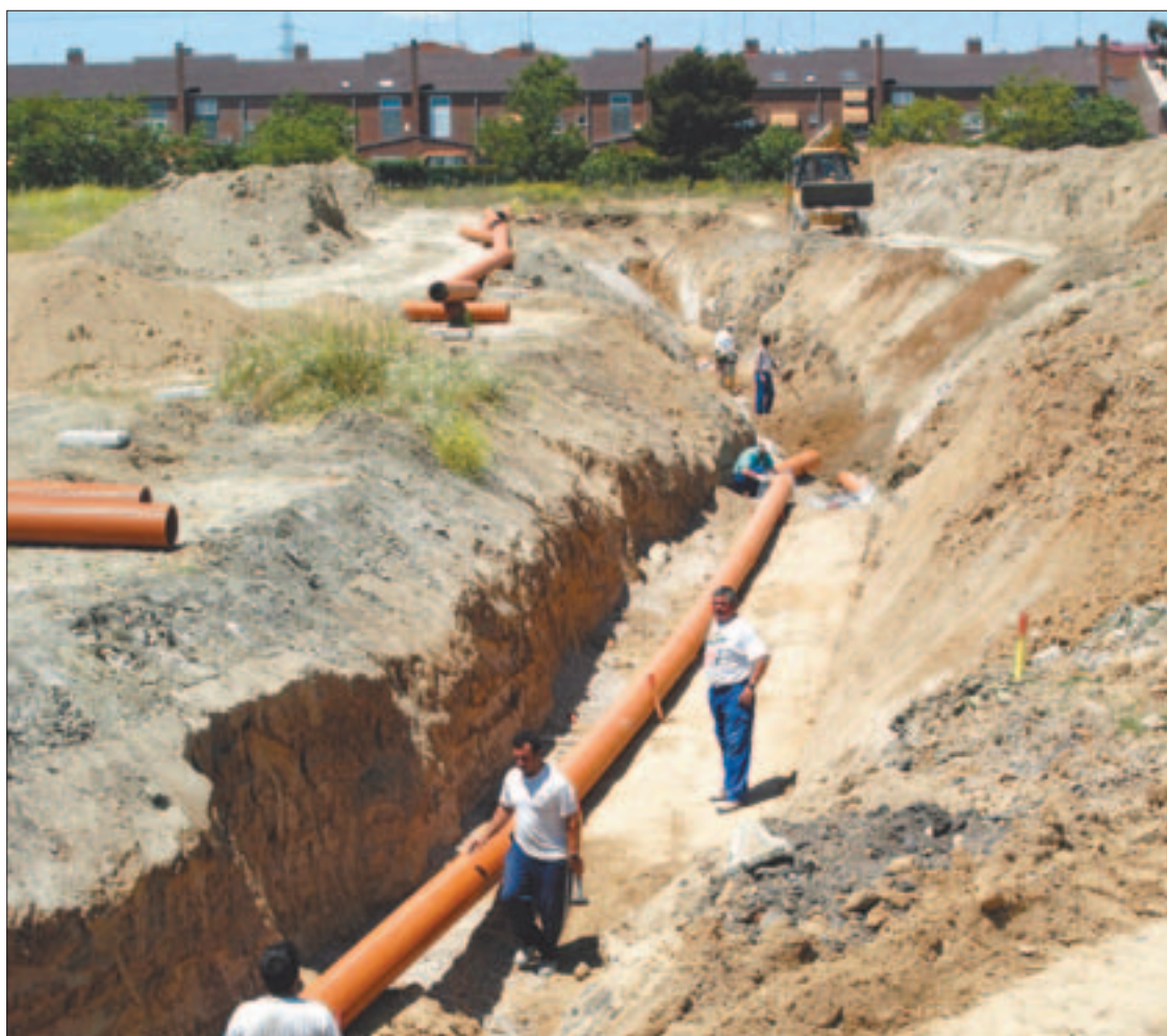
Ya se están colocando los colectores para el saneamiento que permitan, por un lado, evacuar las aguas residuales y, por otro, las fluviales. El tratamiento de ambas será separado.
