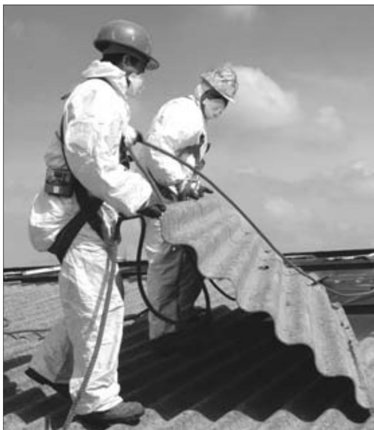
En las demoliciones se prestó especial atención a determinadas naves, para evitar dañar a los trabajadores con la toxicidad de algunos de los productos usados en su construcción.
