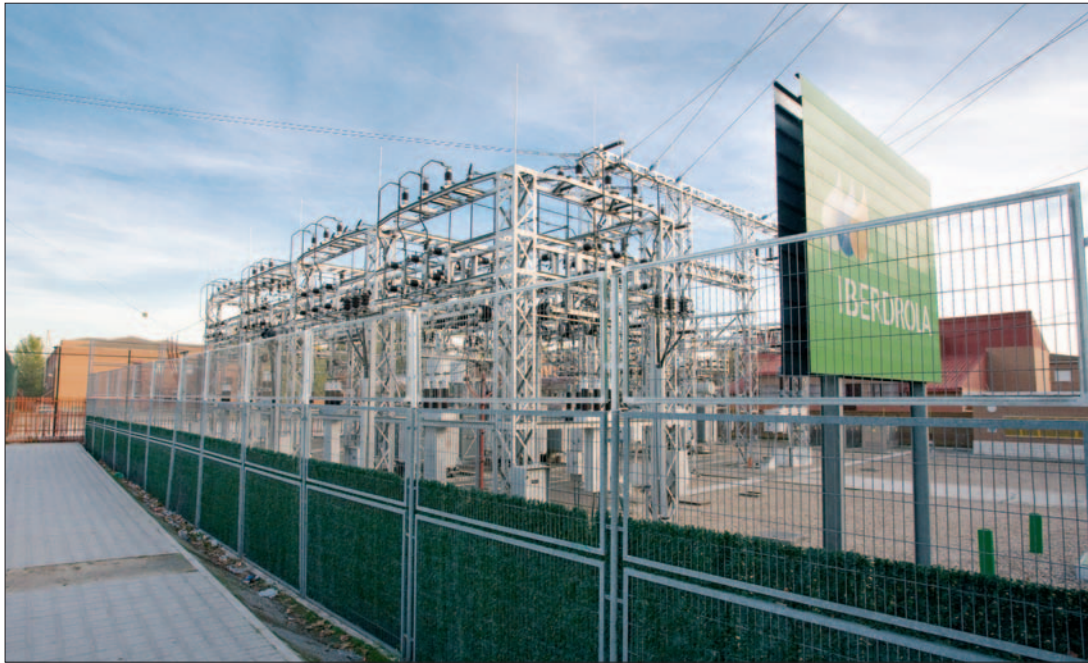
El presupuesto de 2009 recoge el soterramiento de la subestación eléctrica de Juan de la Cierva.
