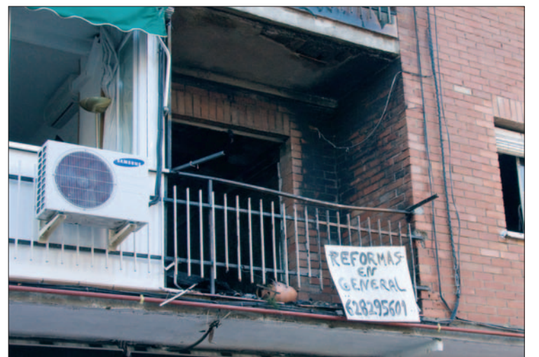
Vista del edificio tras el incendio en la calle Sánchez Morate.
