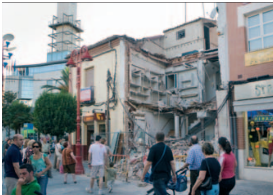
La calle Madrid está sufriendo un lavado de cara, y para ello es inevitable que las antiguas casas que bordean la vía se vean afectadas. En este caso, se ha optado por la decisión más drástica: derribar todo el edificio. Todavía se pueden ver adheridos a los tabiques restos de lo que fue el mobiliario de esta vivienda. Un nuevo piso se levantará en el lugar en el que ahora los viandantes contemplan un inmenso hueco relleno, en parte, por escombros.
