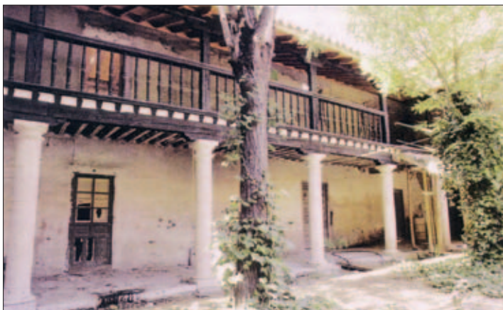
El patio interior del Hospitalillo, durante los trabajos de rehabilitación del mismo, en el año 1985.
