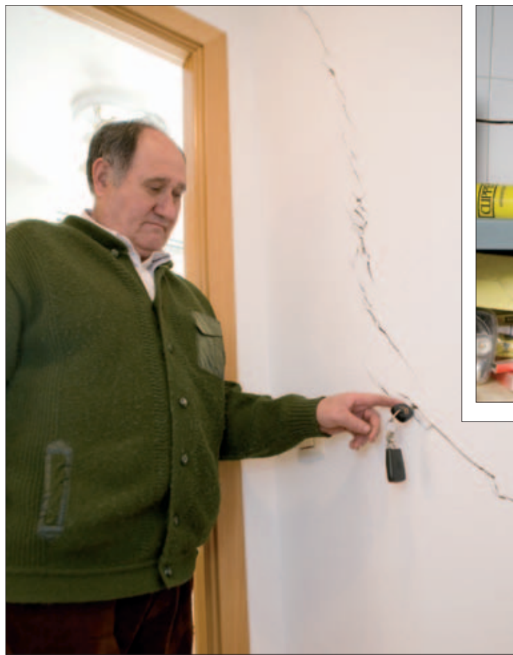
En las grietas de la casa de Luis Sánchez cabe una llave.
