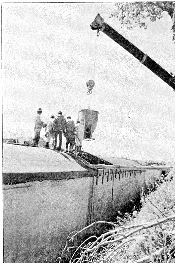
Un momento de la construcción del emisario, de enormes dimensiones como puede apreciarse.
