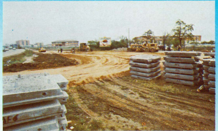
Obras del nudo de enlaces entre la carretera de Toledo, el Sector III, la carretera de circunvalación, y la carretera del cementerio, y comienzo del desdoblamiento de la carretera de Toledo.
