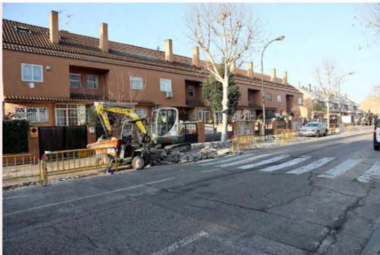
◀ Renovación de las aceras de la calle Islas Canarias en Sector III para facilitar la accesibilidad
