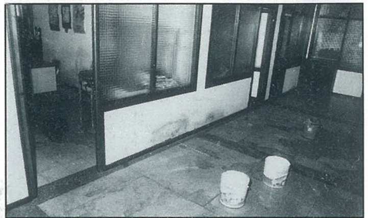
A pesar de que el Servicio de Mantenimiento ha ido al C. C. Juan de la Cierva, la inundación continúa. Foto Miguel Martín
