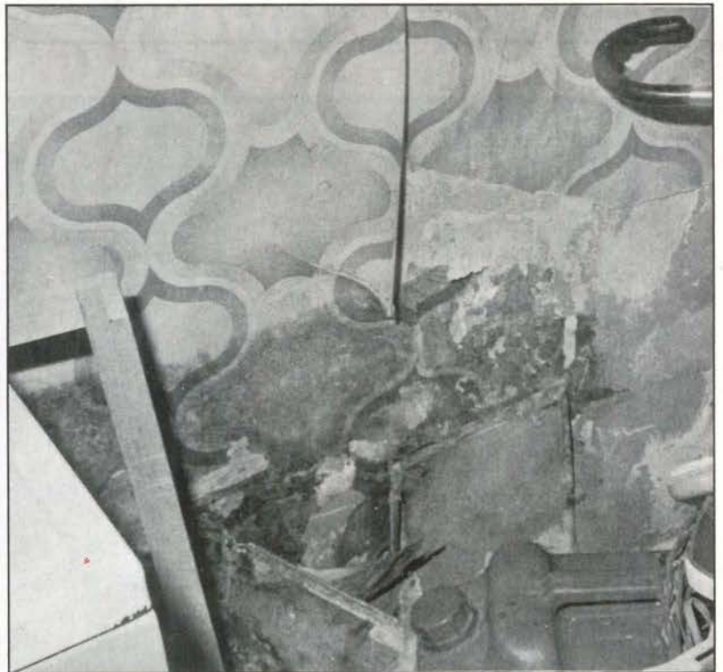
Agujero hecho por ratas para acceder a un piso
