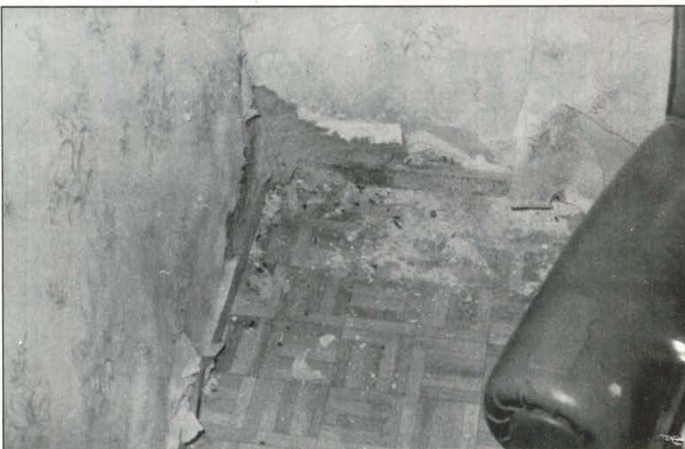
Excrementos de rata en un piso que tuvo que ser abandonado por la presencia de los roedores.
