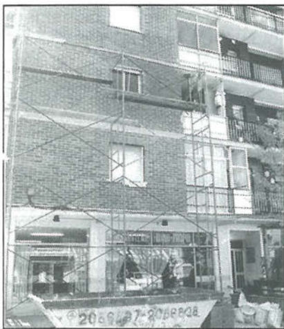
C /Andalucía nº4 uno de los bloques afectados.
